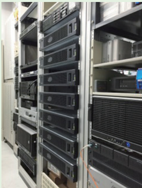
マシンルーム WIRED SERVER
